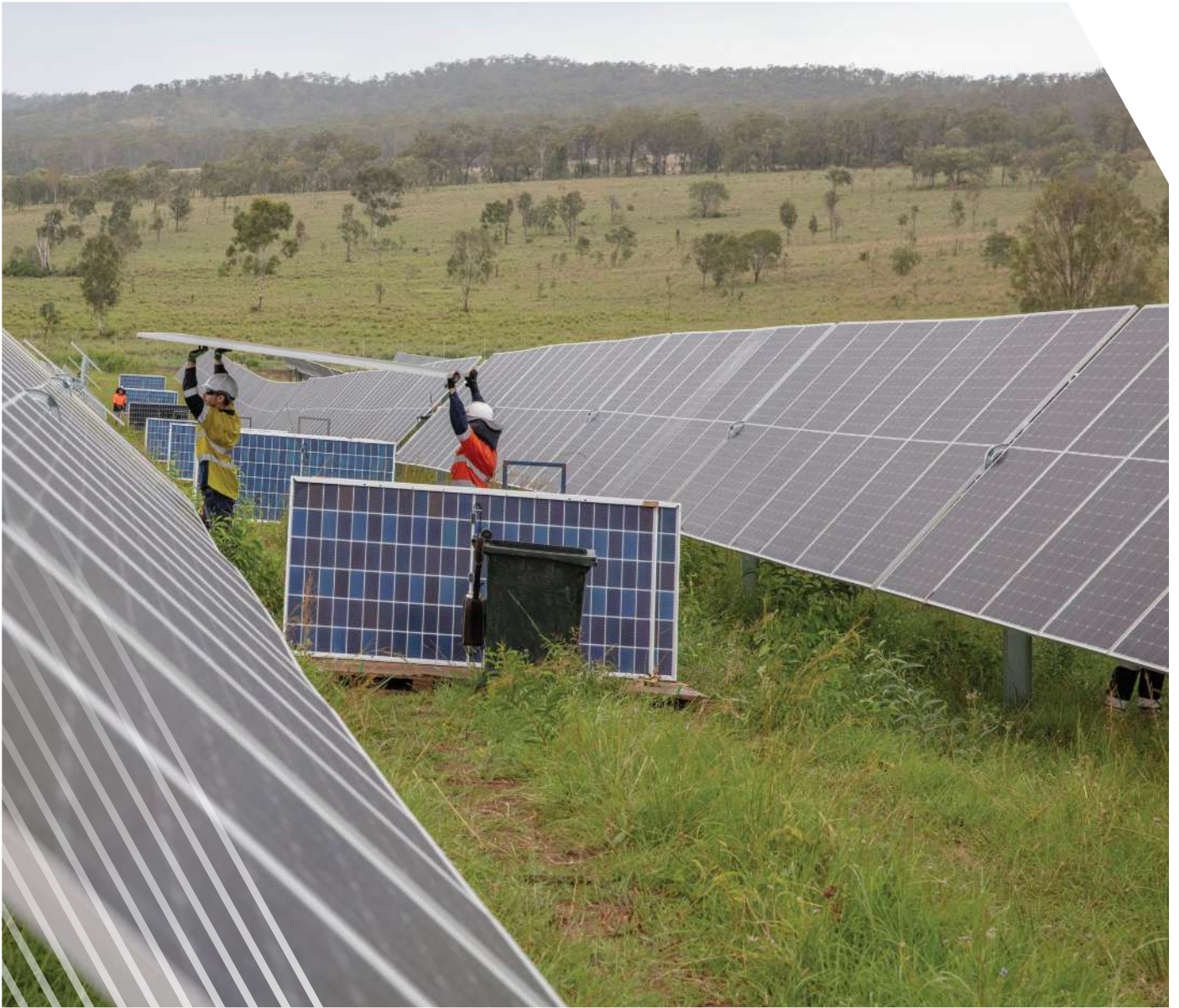
Aldoga Solar Farm. Image Courtesy: ACCIONA Energía.
