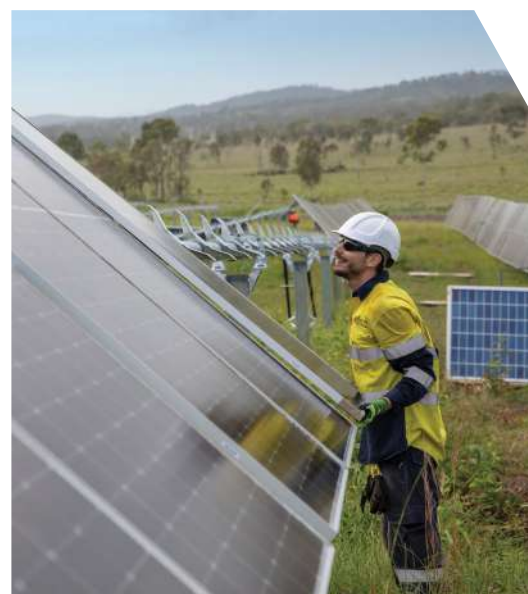
Aldoga Solar Farm. Image Courtesy: ACCIONA Energía.
